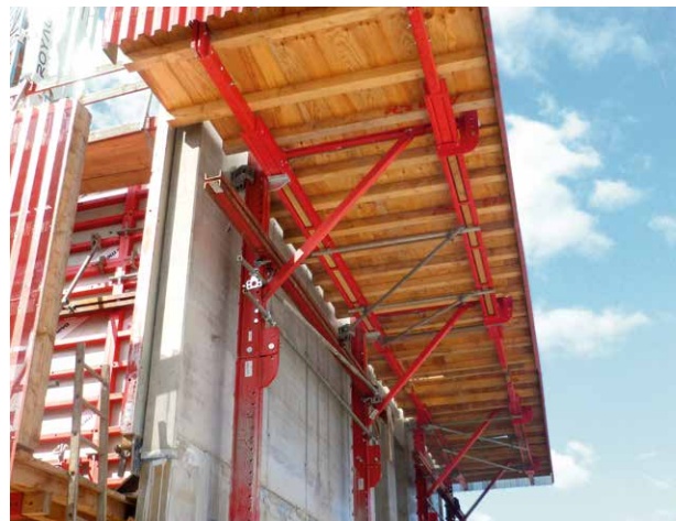
Altijd stevig verankerd aan het gebouw, zowel in de bouw- als in de klimfase.
