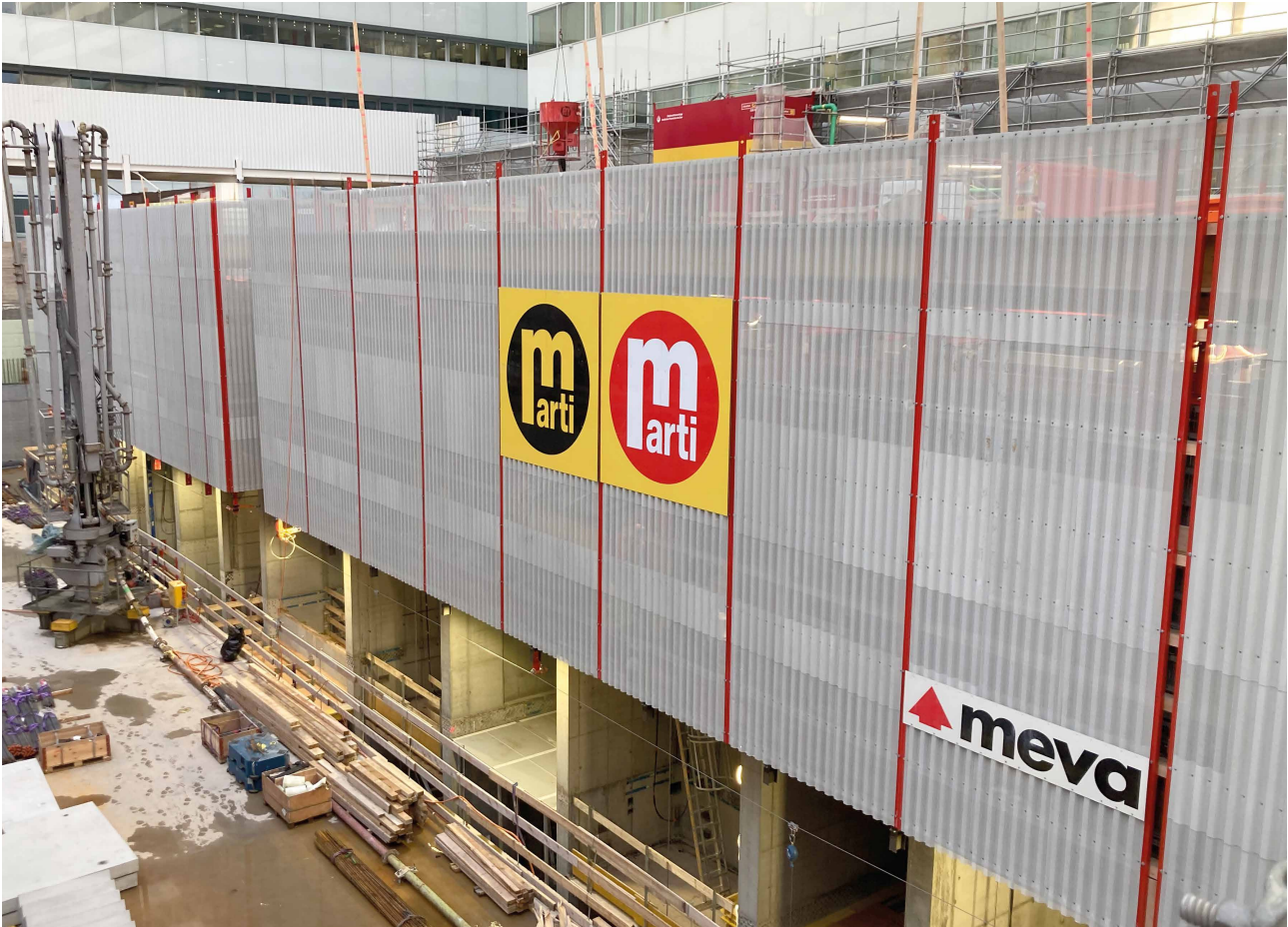
Fent: A két toronyház épületmaga párhuzamosan emelkedik a magasba a 22 méter mélységű munkagödörből. A háttérben a szomszédos magasházak homlokzatai láthatók.
