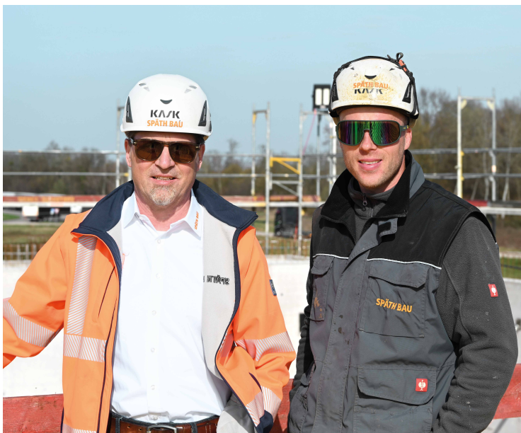
Le chef d'entreprise Christoph Späth (à gauche) et le chef d'équipe Yannick Haid : les pros de la construction du pays de Bade sont satisfaits de la progression des travaux sur le chantier de Lahr.
