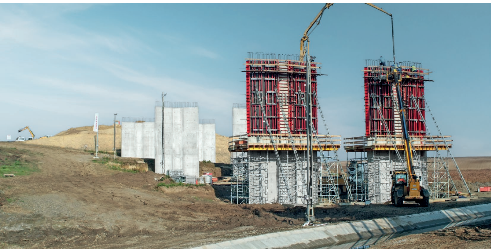
Coffrages et plates-formes de travail sont étayés à l'aide de la tour d'étalement MT 60, les étais obliques Triplex transfèrent la pression du béton frais dans la terre.
