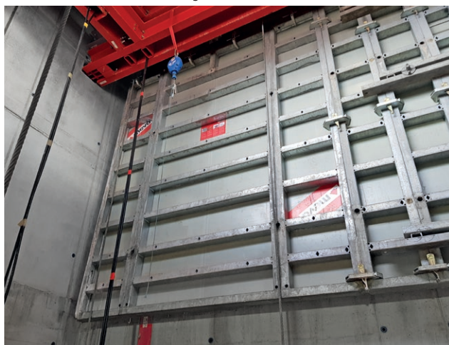
Les panneaux Mammüt en suspension laissent suffisamment de place pour l'exécution des travaux de ferrailage.
