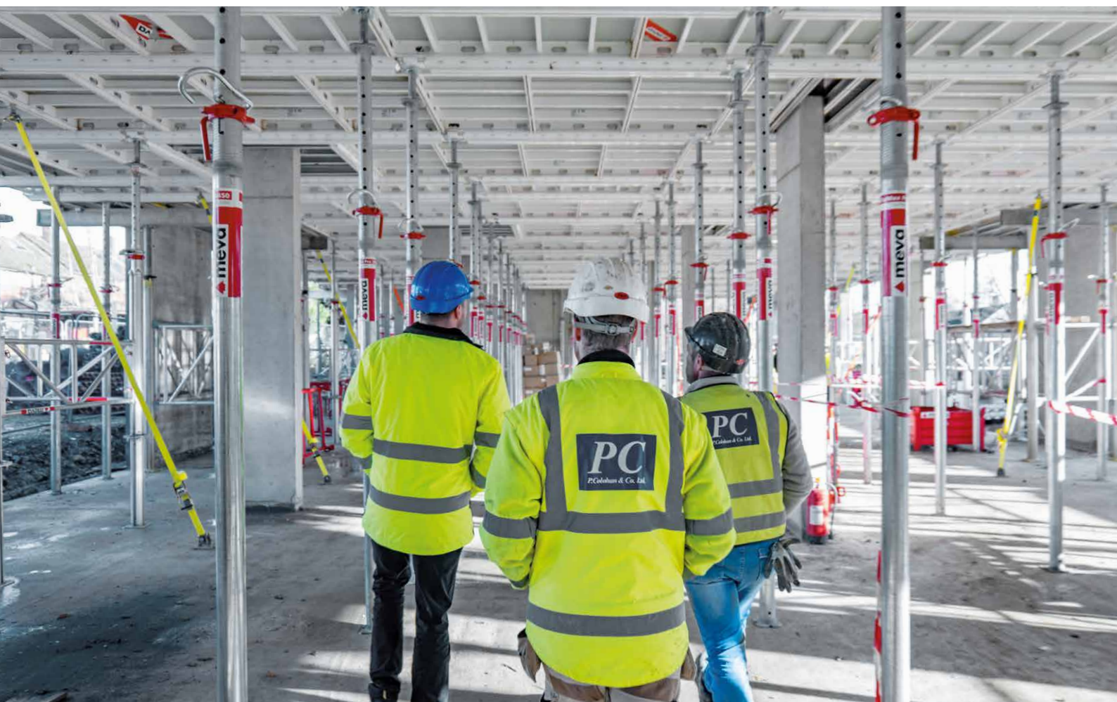
Collaboration réussie entre l'entreprise de construction P. Colohan & Co. Ltd, le fournisseur de coffrages Leeds Acro Ltd. et MEVA.
