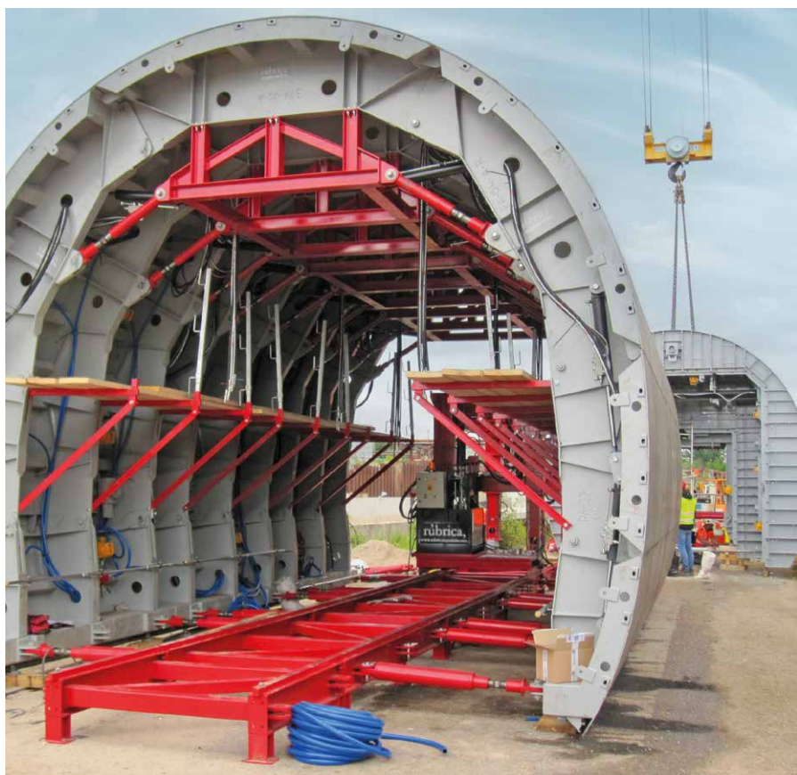
À l'avant : le coffrage de voûte entièrement déployé. À l'arrière : le coffrage monolithique avec coffrage d'about pour la réalisation du bloc central et de l'intersection.
