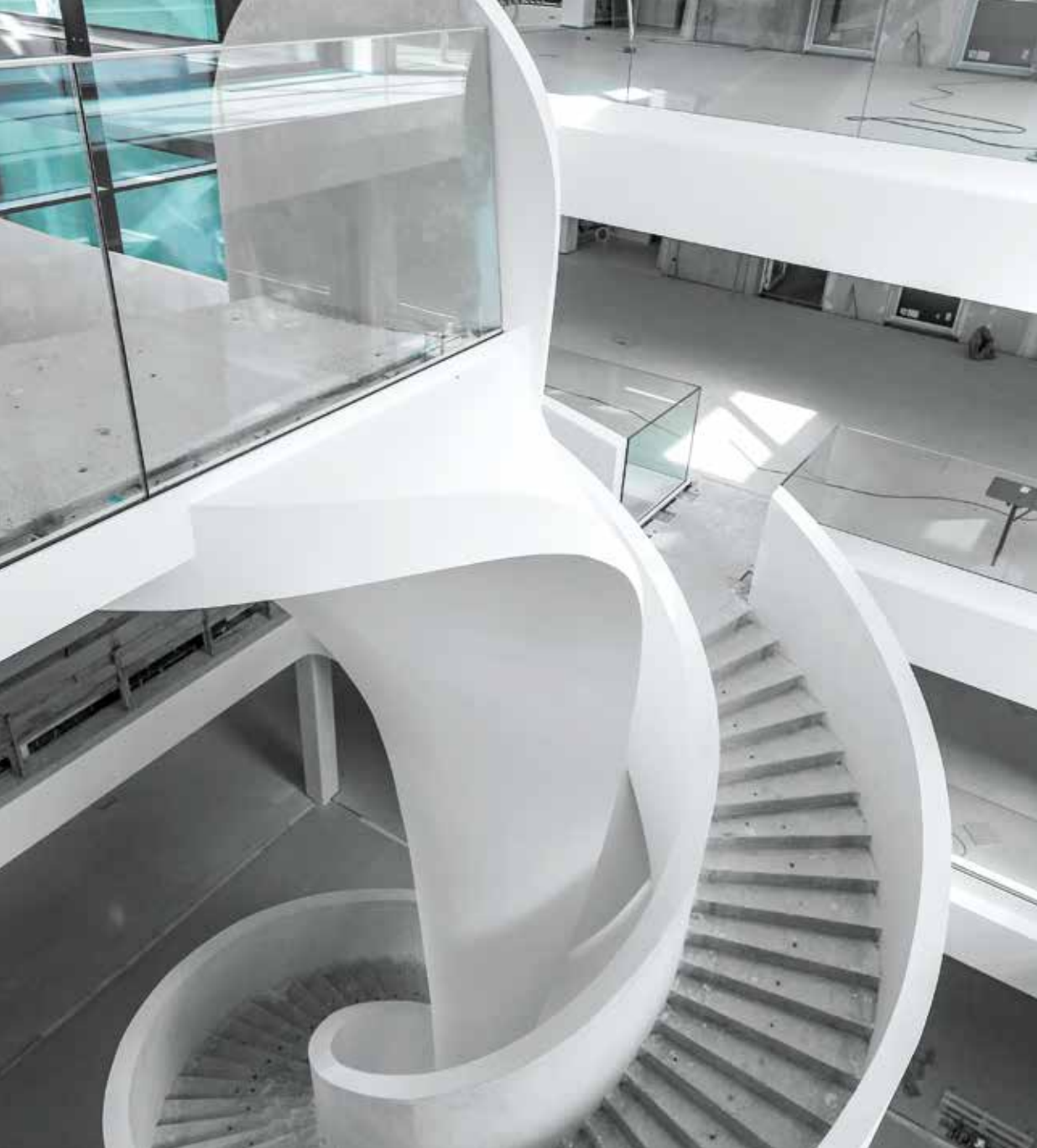
Escalier hélicoïdal de la société AUMA à Müllheim, Allemagne Le coulage de l'escalier a été planifié minutieusement, avec des modules de coffrage praticables, et réalisé dans les délais impartis à la plus grande satisfaction du maître d'ouvrage, de l'architecte et de l'entreprise de construction.
