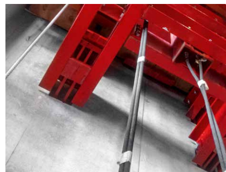
Die Auflagertaschen werden von den Nachlaufbühnen aus demontiert und beim folgenden Klettvorgang wiederverwendet. Dies reduziert die Materialkosten, da keine verlorenen Einbauteile im Beton verbleiben.
