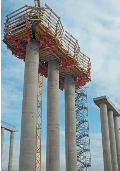
Talbrücke über die Autobahn M6 bei Budapest, Ungarn (Säulenschalung Circo, Klettergerüst KLK 230).
