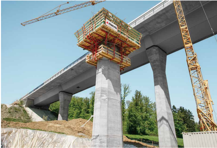
Dultenaugrabenbrücke Süd in Rheinfelden, Deutschland (Klettergerüst KLK 230).
